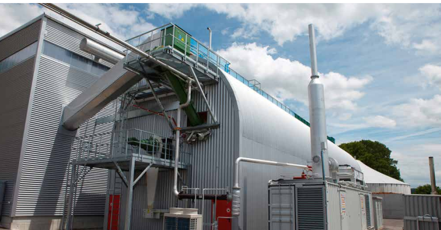
Kompogas® steel digester
